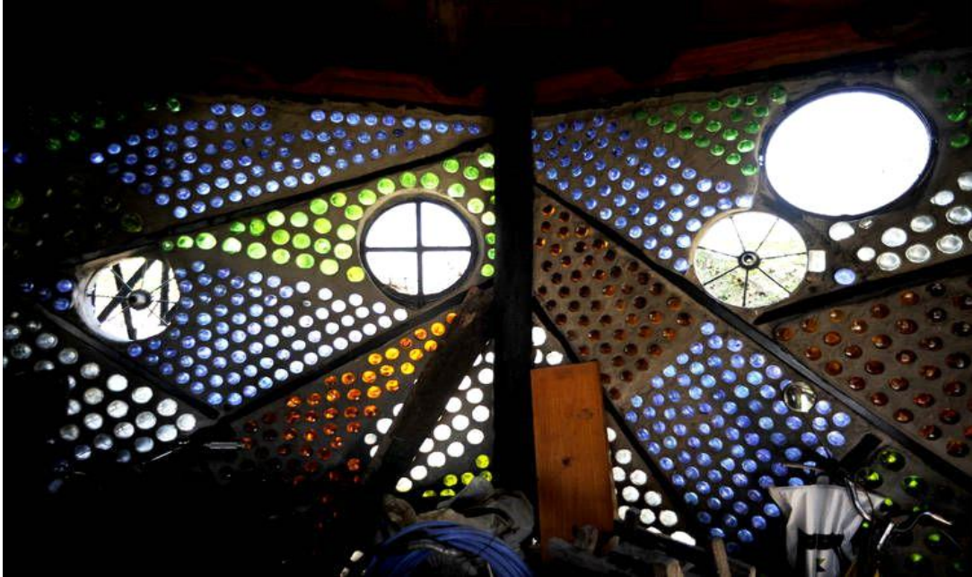
شكل (5) يوضح إستخدام القوارير الزجاجية في سقف المسكن
